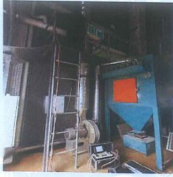
DA003 废气排放口
