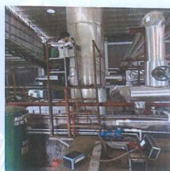
DA006 有机废气排放口
