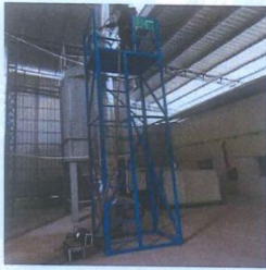
DA008 废气排放口
