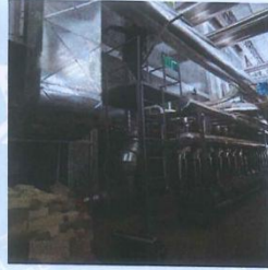
DA004 废气排放口
