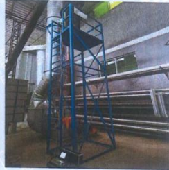
DA007 废气排放口
